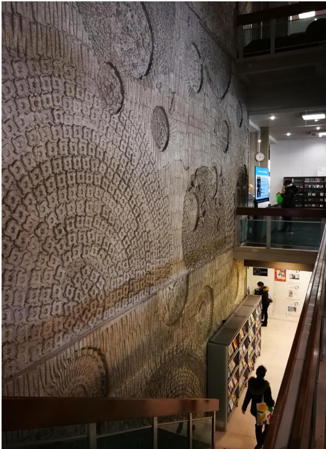
C'est un mur porteur ?
